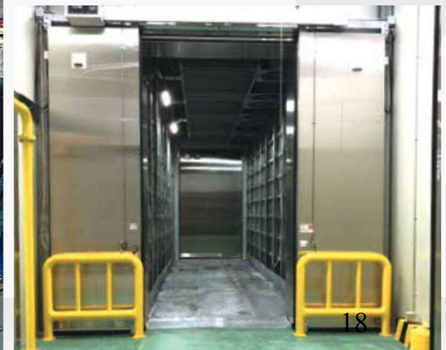
(内装) 急速凍結庫
