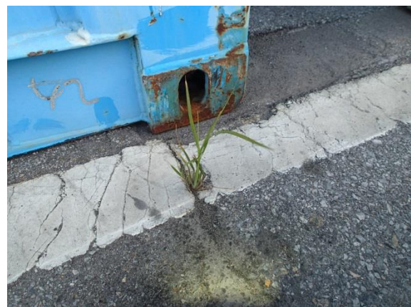
舗装の割れ目から草が生えている場所
