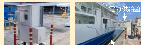
陸上電力供給施設（泊ふ頭地区）
